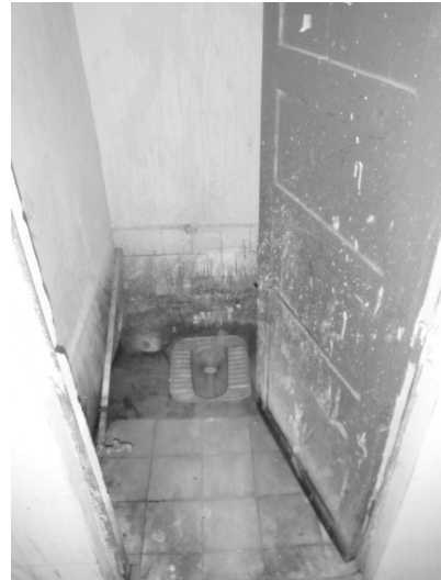
De toiletten naast de slaapzaal kunnen 's morgens vroeg door watergebrek al niet meer doorgespoeld worden.
